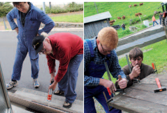
▲ Hannes Stepp und Peter Scheid montieren ein Riffelblech auf die Eingangsstufe; Thomas Mevissen schraubt Metallprofile unter die verzogenen Tische im Außenbereich.
