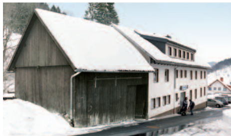
Der marode Schuppen an der Nordseite der Hütte soll durch einen modernen Neubau ersetzt werden.
