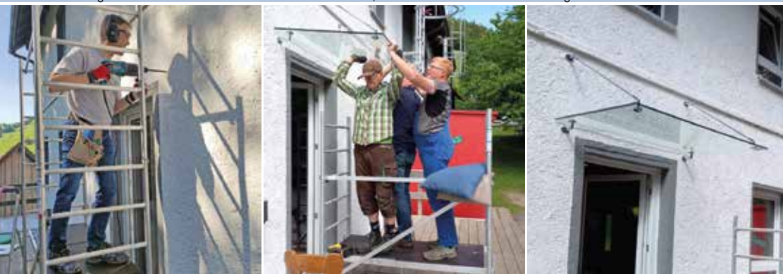
Montage des Glasvordachs: Marco Schmidt bohrt die Löcher, mit vereinten Kräften wird das Dach gehalten und montiert.
